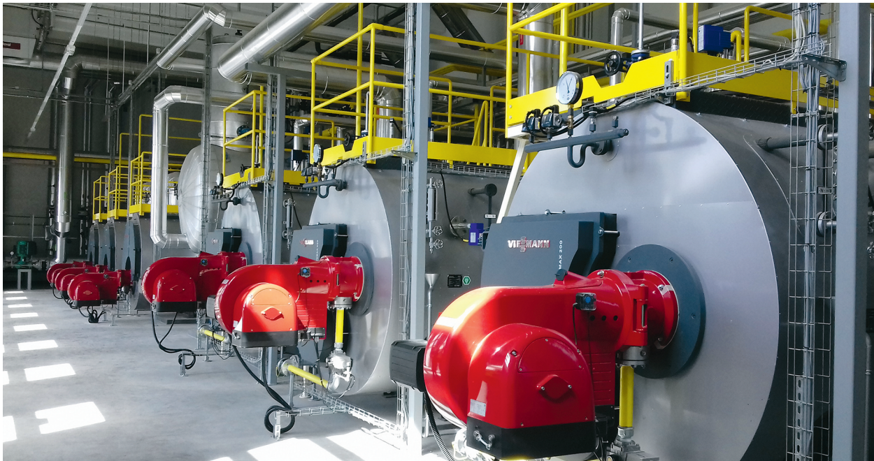
JTI Polska Sp. z o.o. Fabryka Gostków Stary – Kotłownia
